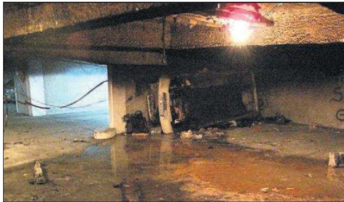
SAINT-OUEN, HIER SOIR. C'est le deuxième incendie en trois jours dans ce parking souterrain ouvert à tous vents, devenu le rendez-vous des dealers. (L.P./D.)
